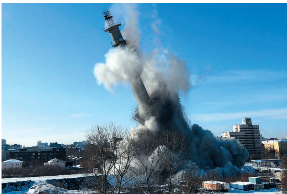
Ученые УГГУ консультируют специалистов, занимающихся организованными взрывами вблизи жилых и промышленных строений. Так, с учетом рекомендаций горняков не так давно был произведен взрыв недостроенной телебашни в центре Екатеринбурга.
